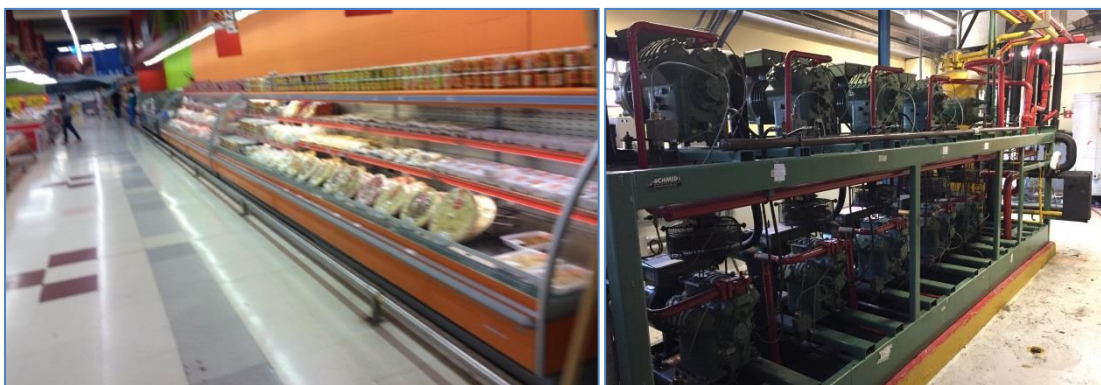
Figura 3.1 – Hipermercado e casa de máquinas Fonte: Autoria da ESCO
