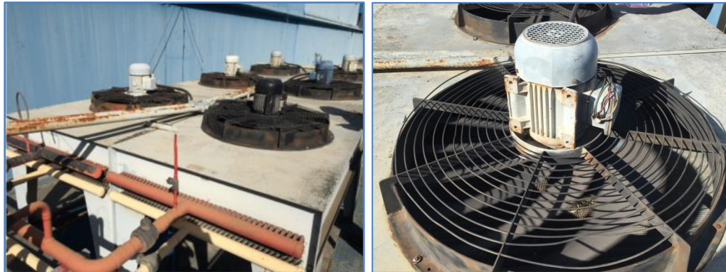
Figura 3.2 – Antes da AEE – ventiladores convencionais Fonte: Autoria da ESCO
